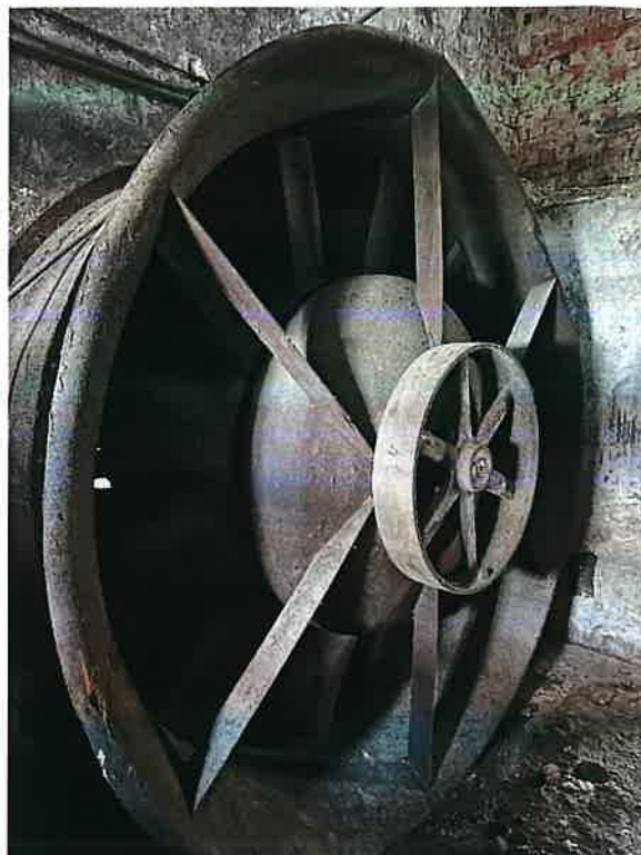
Detaliu ventilator, a doua travee, sursă arhive personale Bâldea Maja, 2023
