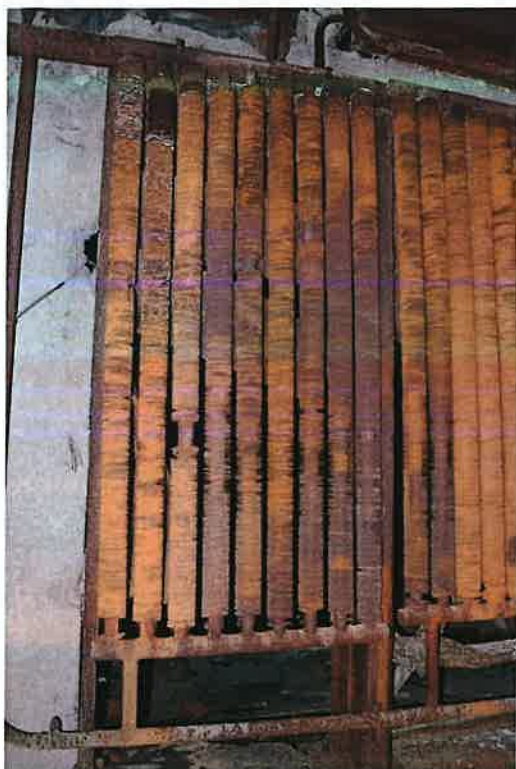
Detaliu schimbător de căldură, prima travee, sursă arhive personale Bâldea Maja, 2023
