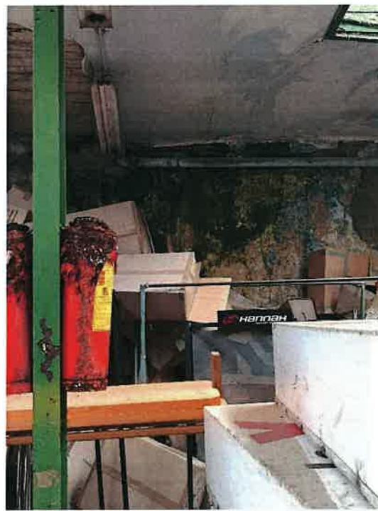
Detaliu degradare perete, sursă arhive personale Dumescu Diana, 2023
